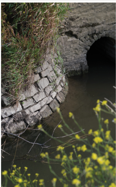
Ancien ouvrage hydraulique à restaurer
