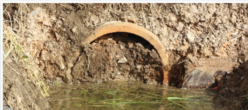
Exemple de buse à restaurer
